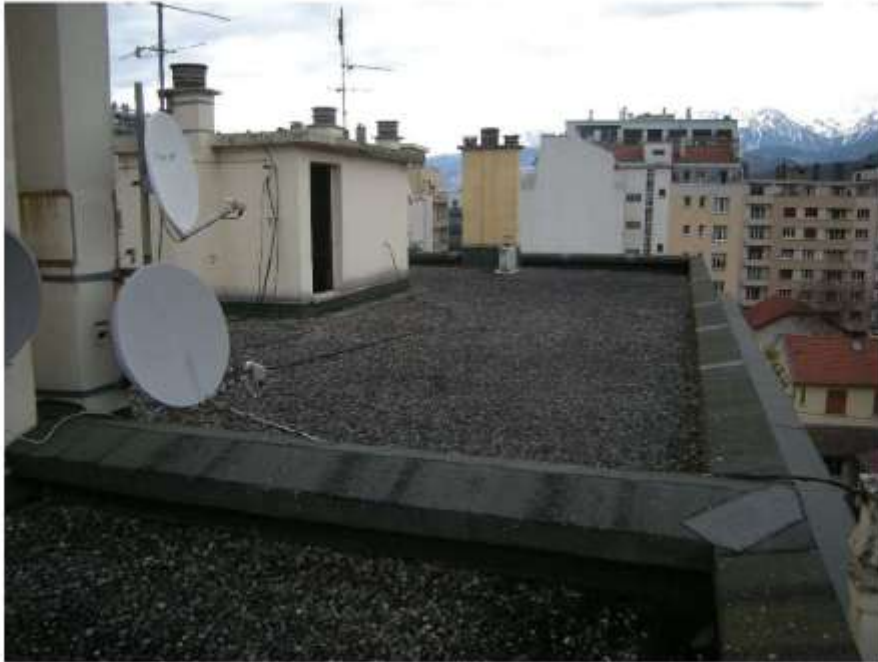
La toiture-terrasse, avec le local technique de la machinerie de l'ascenseur.
